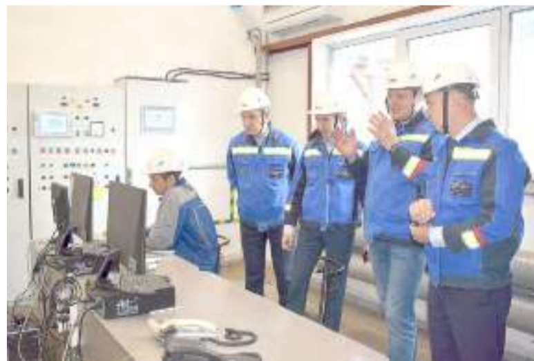
Гости посетили Южную тепловую станцию.
